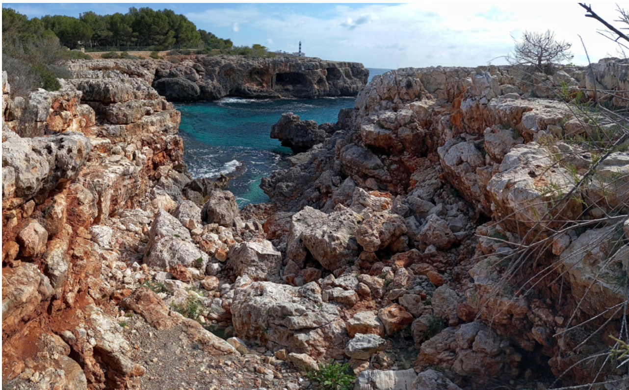
Figura 3: Esbaldregat a la zona NW de Cala Barbacana, fruit del col·lapse d'una cavitat. L'endinsada es converteix en el punt més baix dels penya-segats i on és més probable que acabin penetrant les aigües marines, formant una caleta. D'aquesta manera es demostra el paper protagonista dels processos càrstics en la fisonomia d'aquest tram litoral (Foto: G. Santandreu).
