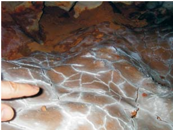
Foto 4: Detalle del conjunto de grietas rellenas por pequeñas venas de calcita. Foto Toni Merino.
