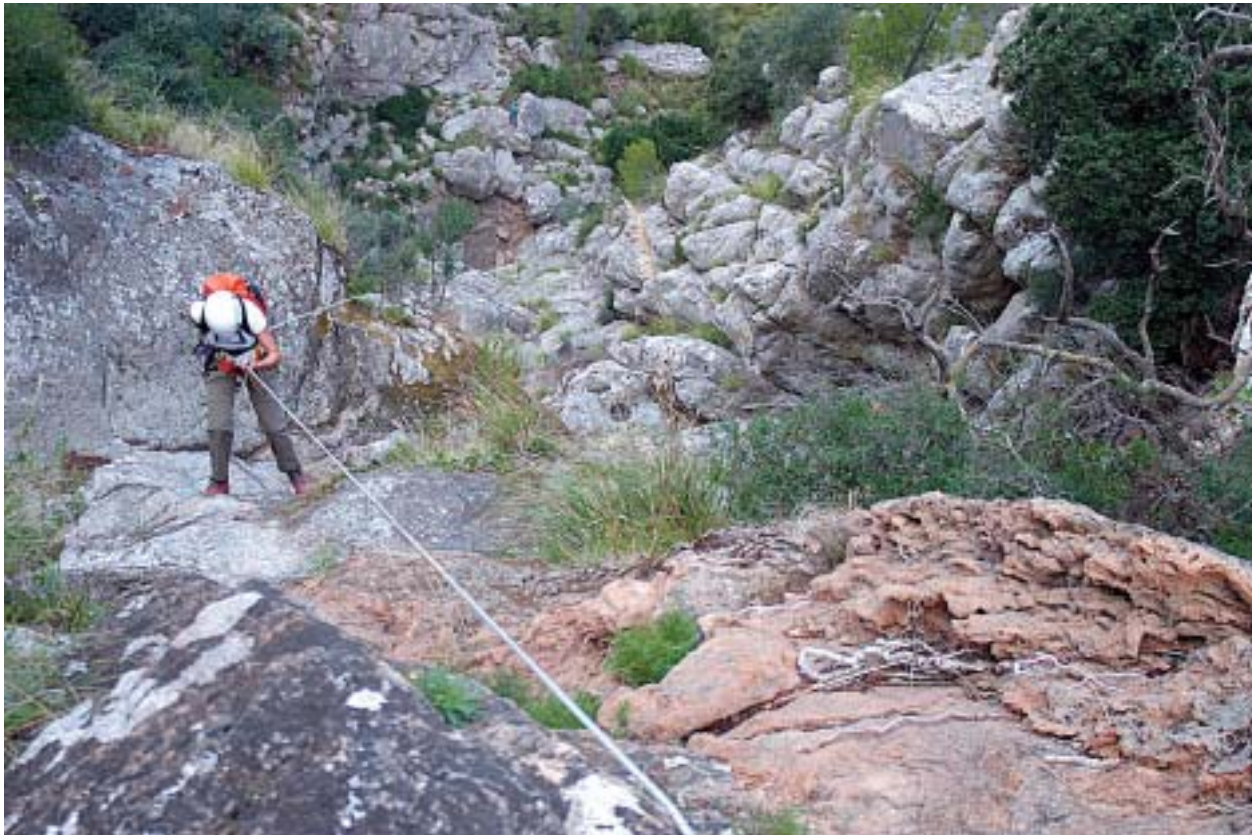
Foto 7: Torrent de s'Hort de sa Cova. Capçalera del S 114. S'aprecia la part descomposta del dipòsit de tosca. Foto: R. Romero.
